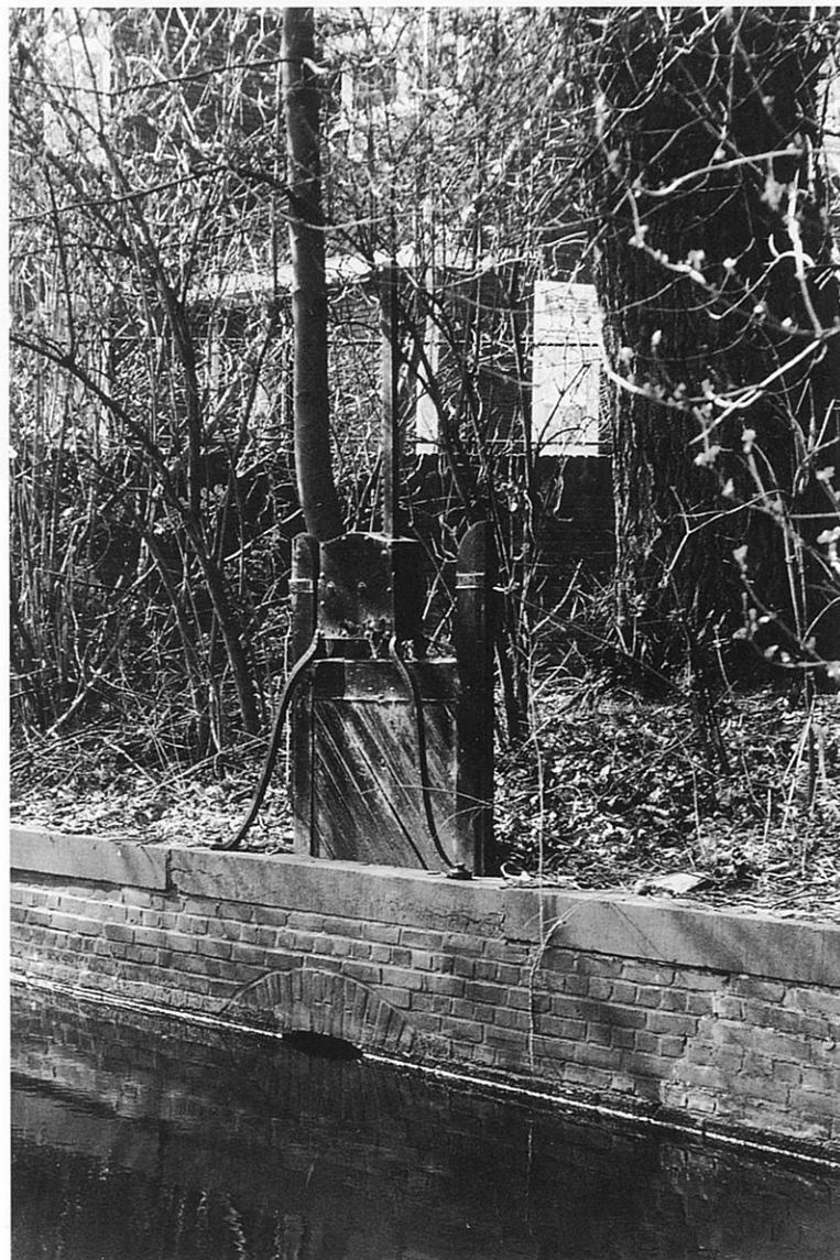
Afsluiter van de duiker bij de Van Pabstlaan.
